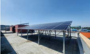
대동기어 태양광 발전설비
